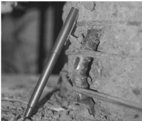
(a) Longitudinal Bar Buckling
