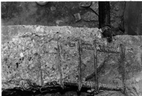
(d) Total Spalling of Concrete Cover.
