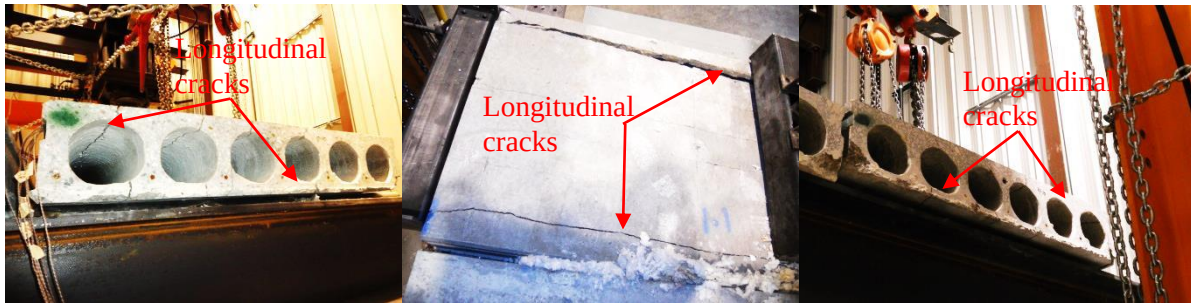
a. Slab 2, longitudinal cracks b. Slab 5, longitudinal cracks c. Slab 6, longitudinal cracks
