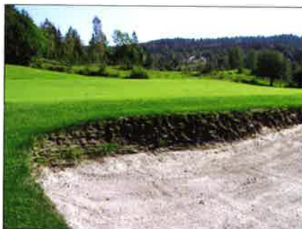
Torvforblandet kant passer kanskje ikke alle steder? Slike kanter varer ikke så lenge, og må bygges om før det er gått 10 år. Bildet er fra Bærum GK.
